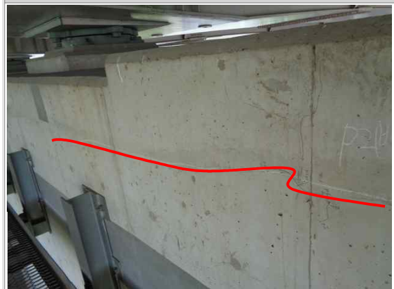
P2 코핑부 균열 (cw=0.3mm미만)
