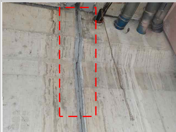
A2 Joint부 실란트 파손
