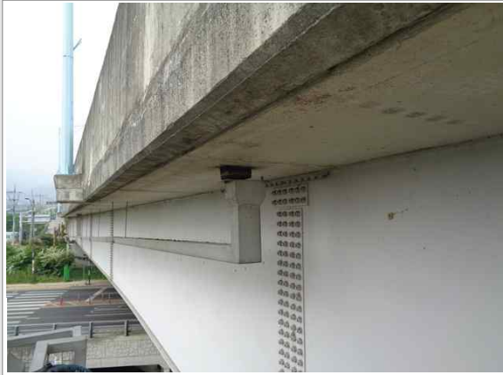
<S2> 배수관 탈락
