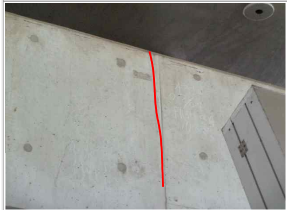
P1 코핑부 균열 (cw=0.3mm미만)
