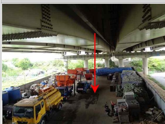
<S3> 배수관 막힘 및 누수에 의한 하부 물고임
