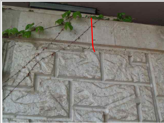
A1 균열 (cw=0.3mm미만)
